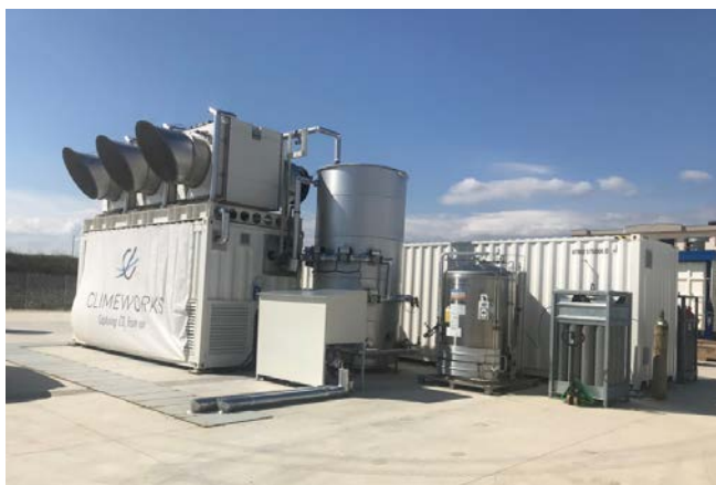
Fig. 6 - Vista parziale dell'impianto di Troia
